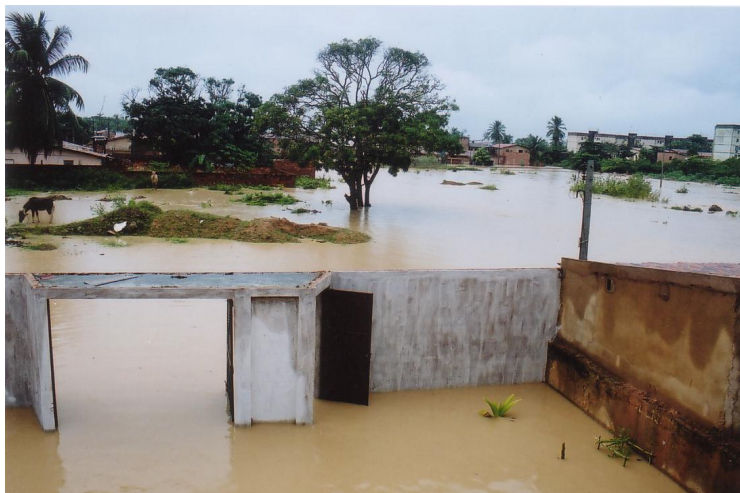
Figura 38 – Situação próxima à seção 3, devido às chuvas ocorridas em 01/06/2004.
