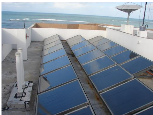
Foto 05: Placas solares Fonte: Cipesa, 2007
